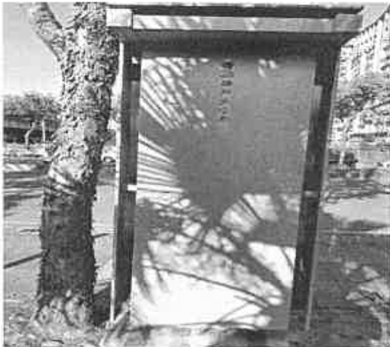
圖 2.4.1-3 自來水公司水閘控制設備
