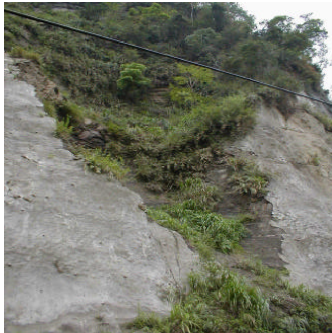
照片六 噴漿工法造成坡面與原植被交界面產生弱面
