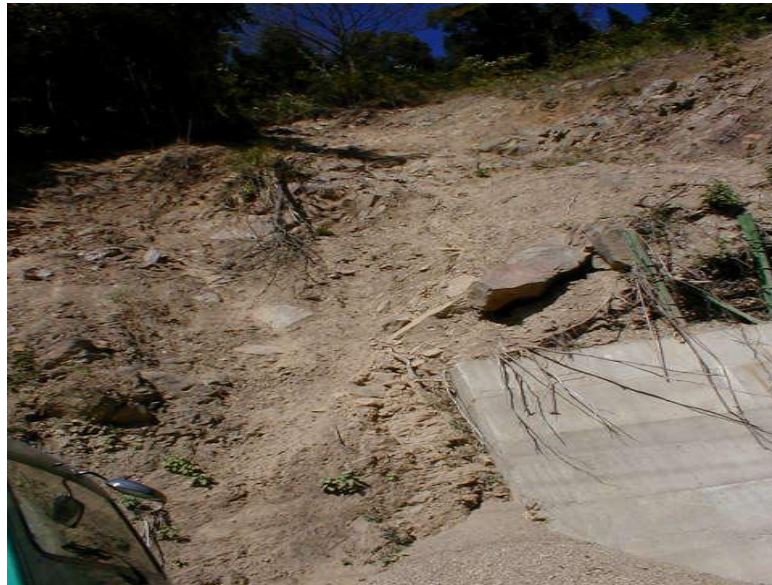
照片三 擋土牆長度不足造成毀壞之現況
