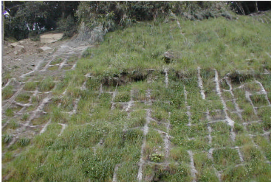
照片七 型框護坡欠缺排水設計導致植栽工程失敗
