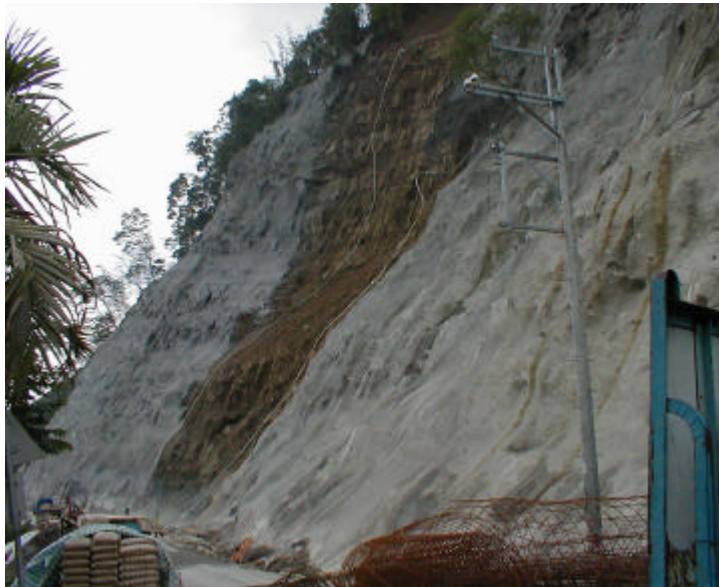
照片五 噴漿工法坡面排水問題
