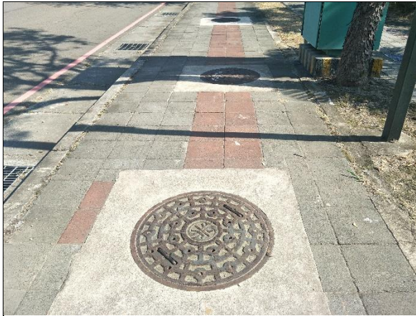
地下管線充斥人行道，平整性不佳
