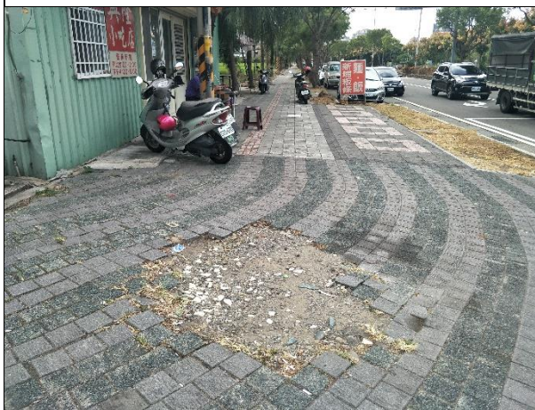
面磚破損，鋪面不平整
