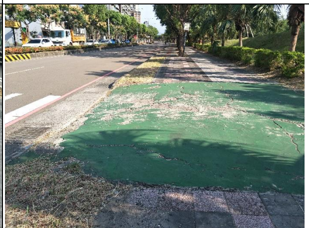
無障礙斜坡道年久失修
