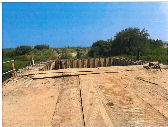
說明：施工拔除的鋼筋、寶特瓶垃圾請再清除 日期：110/9/1
