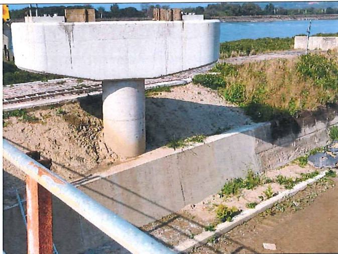
說明：橋墩周邊裸土坡請加強灑水避免揚塵及空氣汙染 日期：111/3/9
