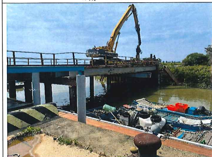
說明：構台未阻隔水流 日期：110/06/01
