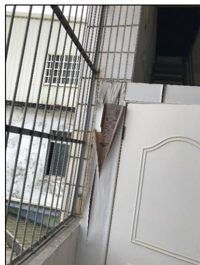
二樓大門(老舊損壞)
