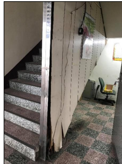
木質牆板長期滲水腐壞
