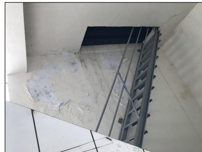
天花板時有滲水情況
