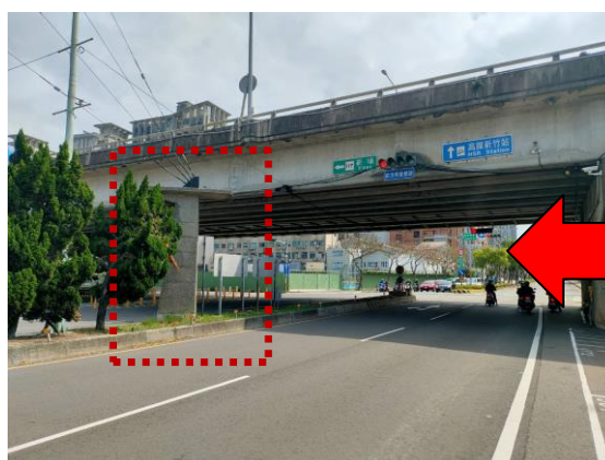
自強南路纜線固定座現況照片
