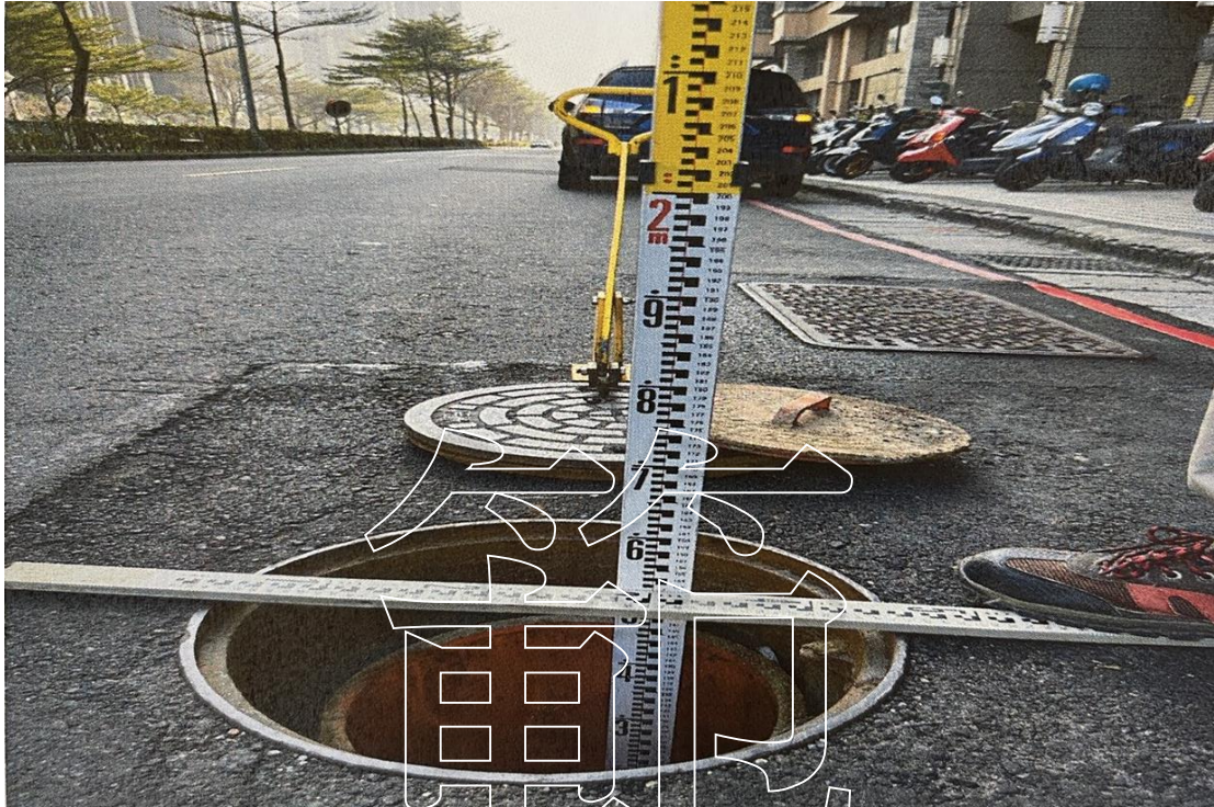
勝利七街公共陰井編號:A2744-19，測量深度:1.52 公尺
