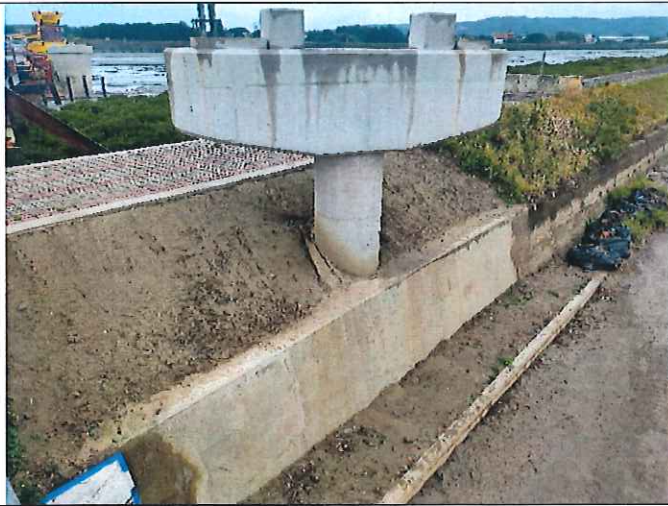
說明：橋墩請加強表土覆蓋，避免土壤流失 日期：110/12/27
