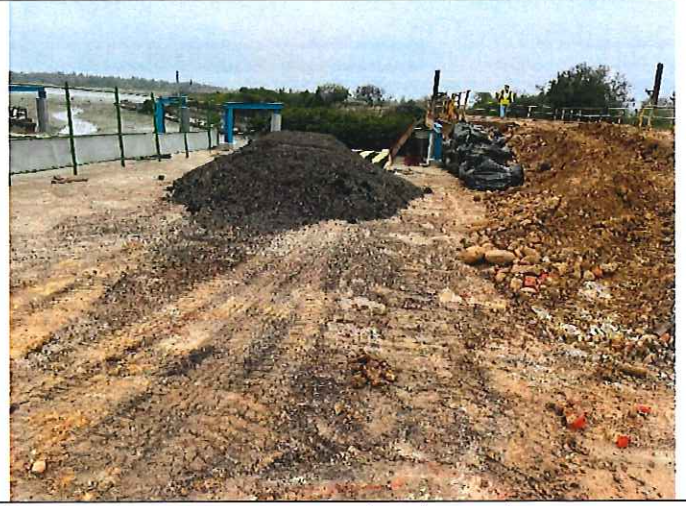
說明：強風來臨建議採用塑膠布覆蓋，平時採用灑水降低揚塵 日期：110/03/09
