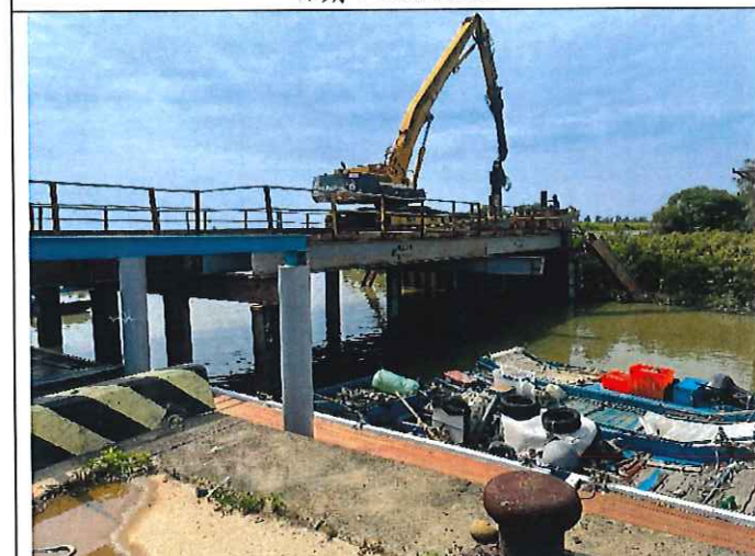
說明：構台未阻隔水流 日期：110/06/01
