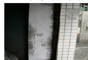
地下室柱爆裂
