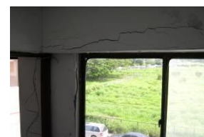
梯廳樑柱龜裂
