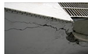
外牆鋼筋外露
