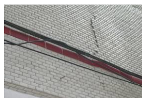
外牆立面龜裂
